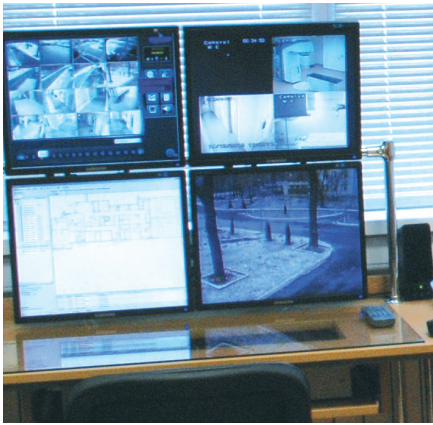
Рабочее место оператора систем видеонаблюдения и охранной сигнализации
