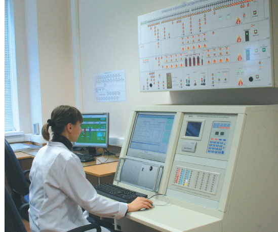
Рабочее место оператора систем противопожарной защиты
